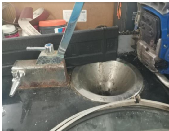
Deterioro en las llaves de las mesas del laboratorio
