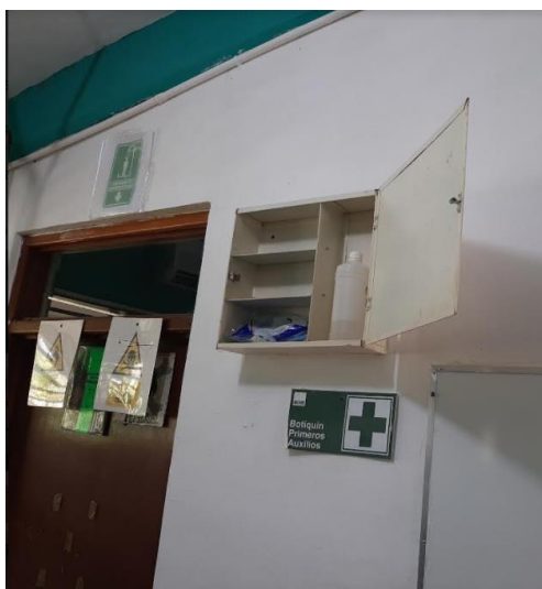
Botiquín sin materiales básicos
