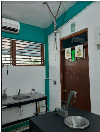
Regadera de emergencia funcionando correctamente
