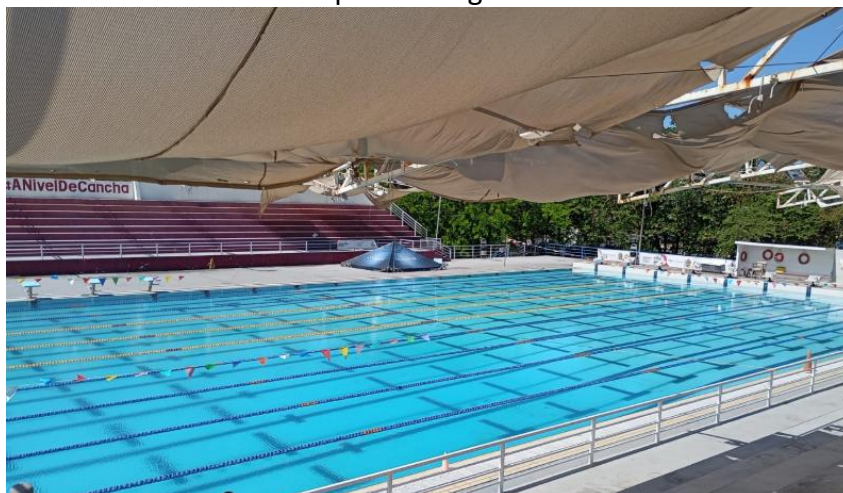
Área de gradas se requiere cambio de velarías.
