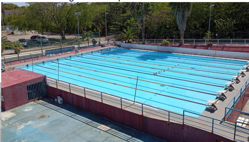
Estructura metálica dañada, pintura vinílica.
