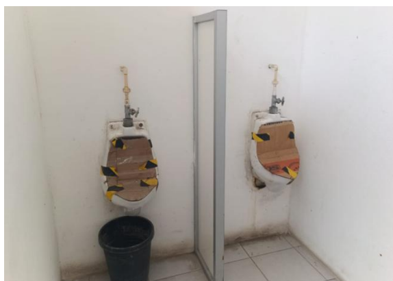
Muebles sanitarios fuera de servicio.
