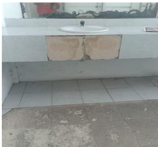
Loseta en baños en mal estado.
