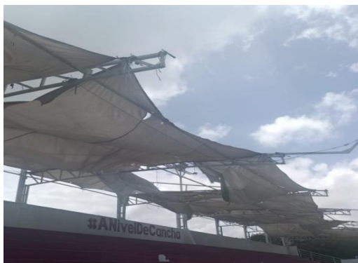
Malla sombra en mal estado, estructura dañada
