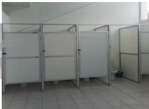
Mamparas en mal estado.
